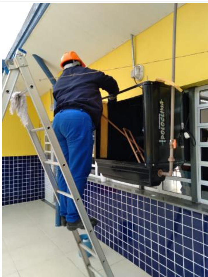
Limpeza dos climatizadores 23-07-2021 (1)
